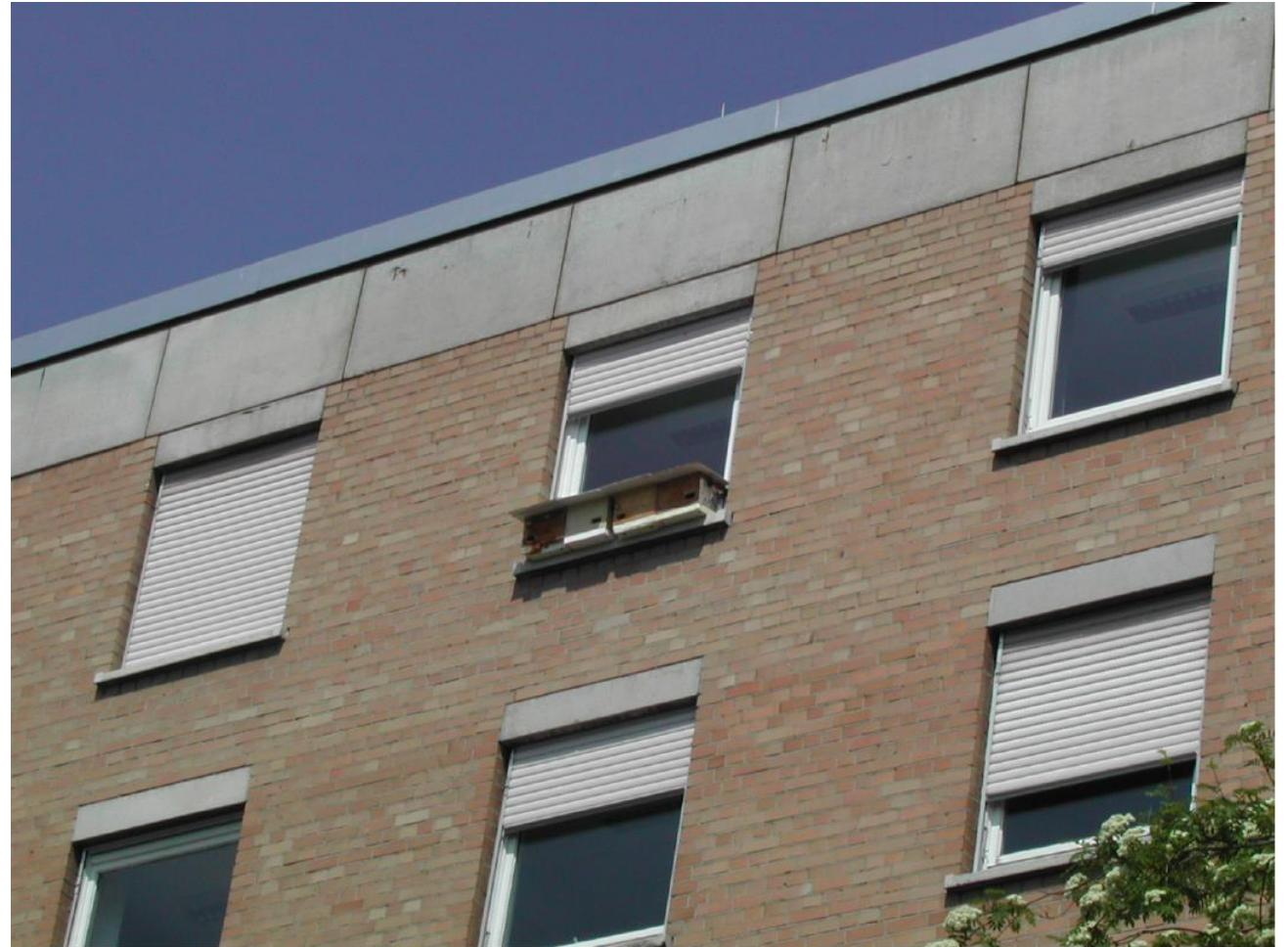
Die unterschiedliche Farbe ist die Patina der Jahre und zeigt die Reihenfolge der Installation
